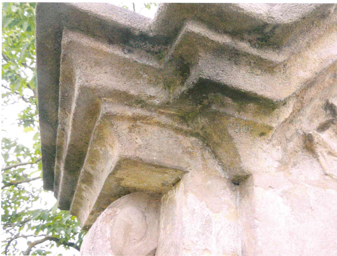
Kostomlaty n. Labem, socha sv. Jana Nepomuckého, detail krust, doplňků, koroze kamene, ale i starších povrchových úprav na spodní straně římsy podstavce – stávající stav
